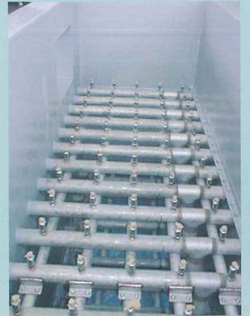
アンモニア注入器
